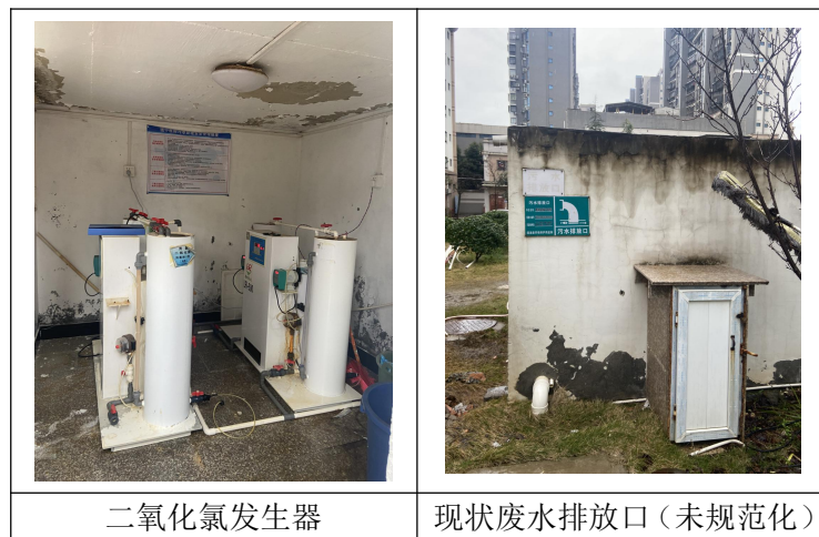
图 3.1-3 污水处理站现状
