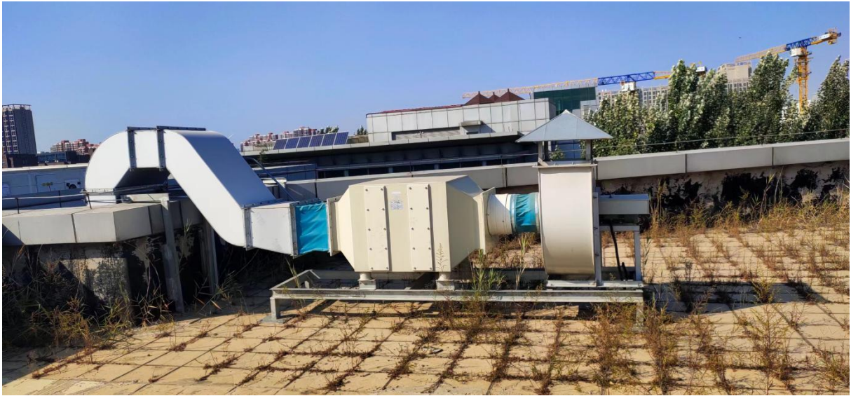
图 4-2 废气排放口及设备图
